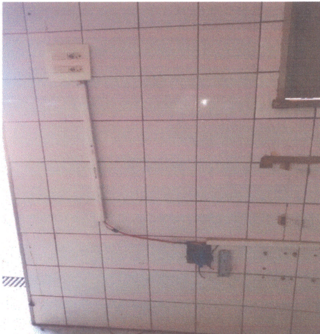
Foto 1 – Tomada, interruptor deteriorado e fiação exposta
