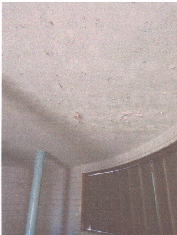
Foto 9 – Laje com pontos de Infiltração e umidade
