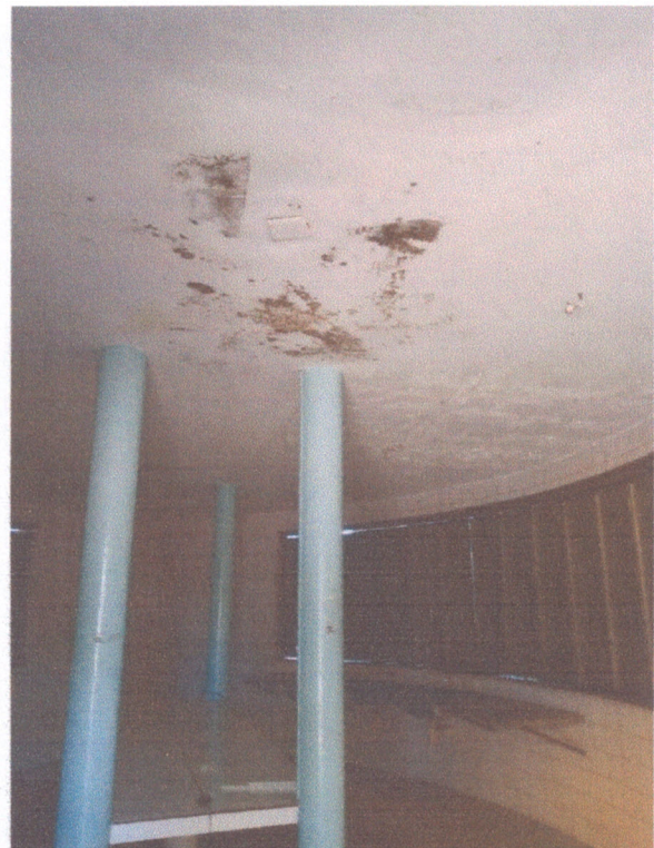
Foto 10 – Laje com pontos de infiltração e mofo
