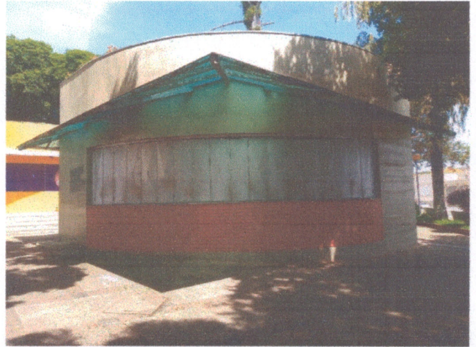
Foto 12 – Janela e parede externa com pintura desgastada
