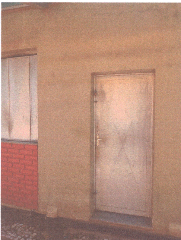
Foto 13 – Porta e parede externa com pintura desgastada
