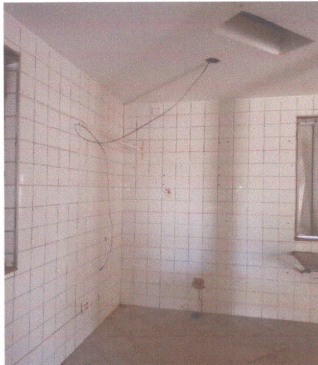
Foto 4 – Tomada deteriorada e fiação exposta
