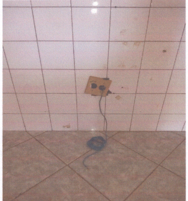
Foto 2 - Tomada deteriorada e fiação exposta
