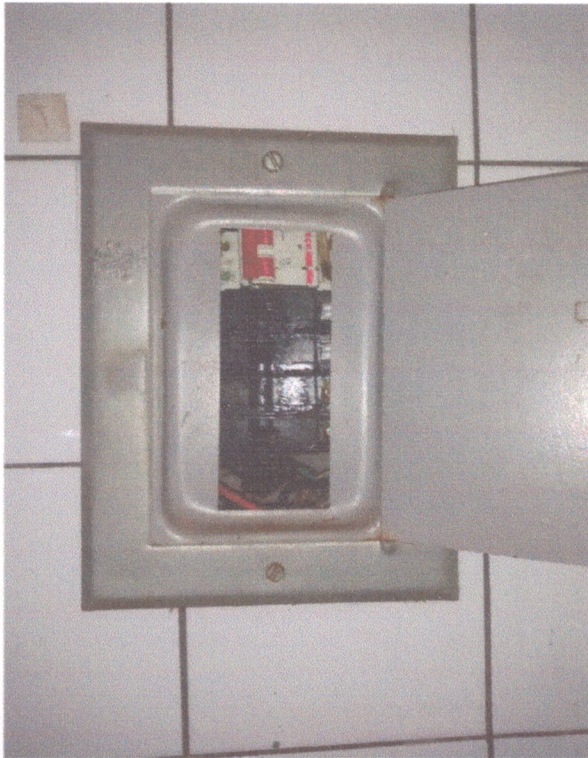
Foto 7 –Quadro de distribuição com infiltração
