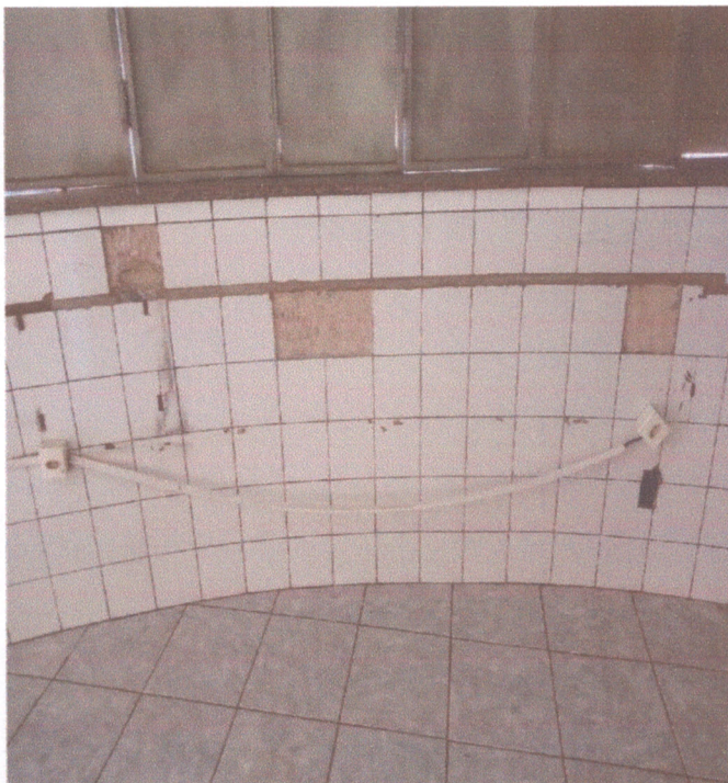
Foto 3 – Tomada deteriorada, fiação exposta, deslocamento do revestimento e recortes na alvenaria
